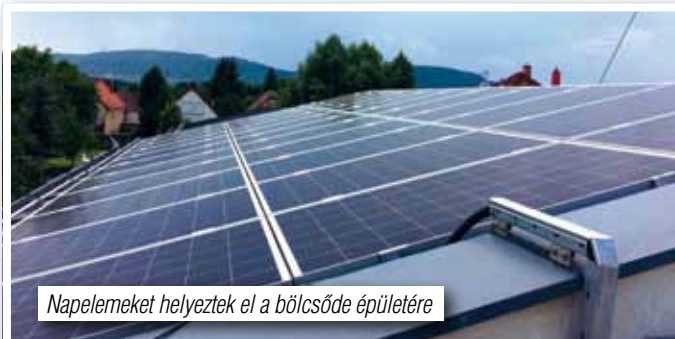
Napelemek az óvoda épületének tetején
