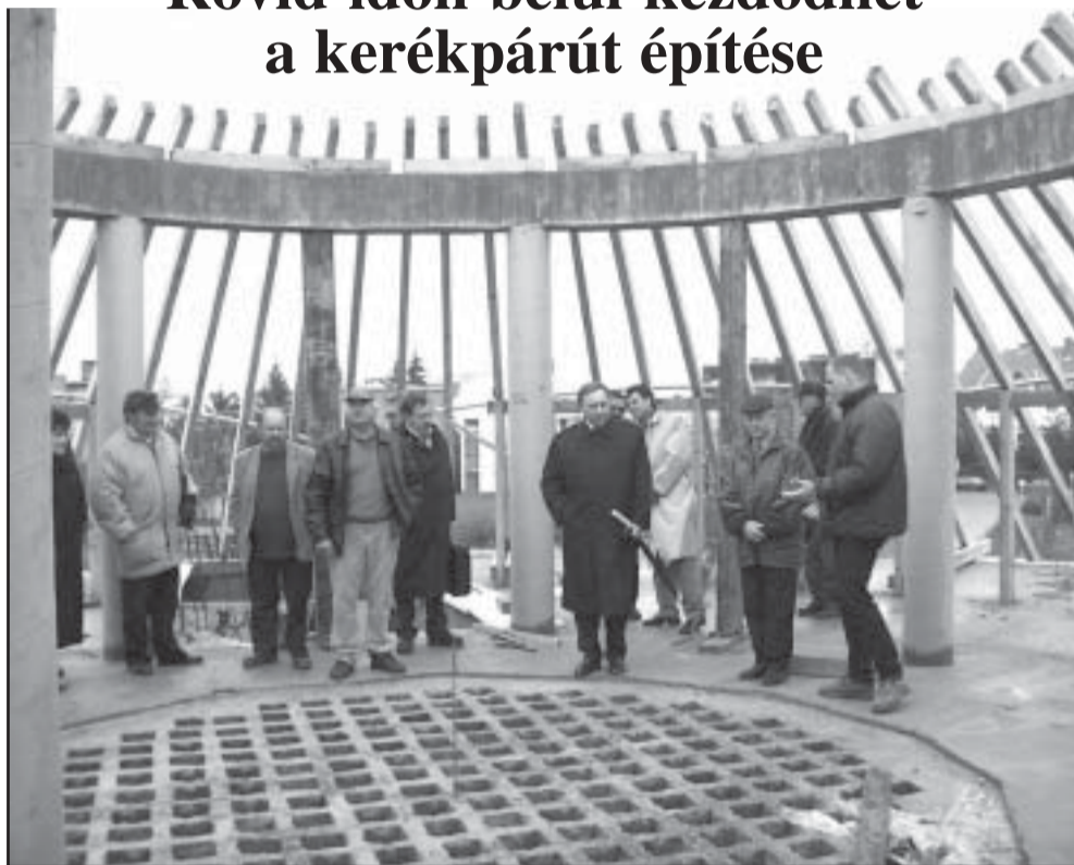
A képviselők a harmadik emeleten hallgatják Jantyk Károly építésvezető (jobb szélen) tájékoztatását. Jelenleg a tetőszerkezet ácsolását végzik.
