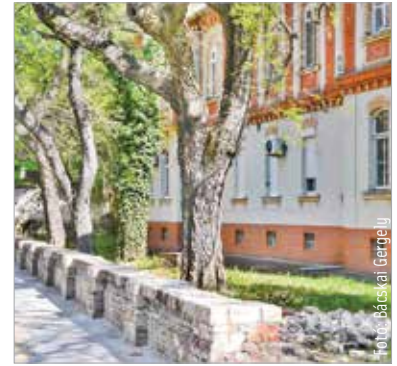
Éltveszélyessé vált a kerítés, le kellett bontani
