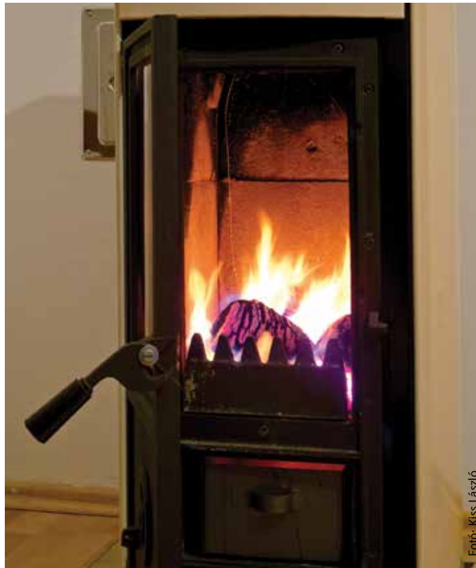
Szilárd tüzelőanyaggal üzemelő berendezés közelében nem szabad éghető anyagot elhelyezni
