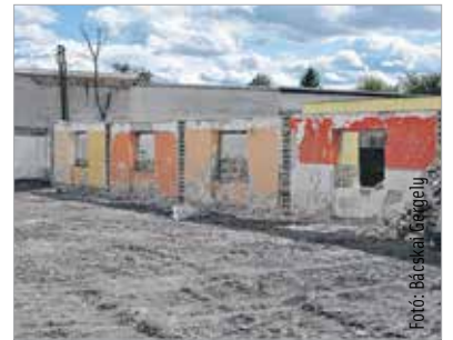
Az önkormányzat elszánt: az emberi életre alkalmatlan lakótömböket jogszerű eljárás keretében mindenütt felszámolja a városban
