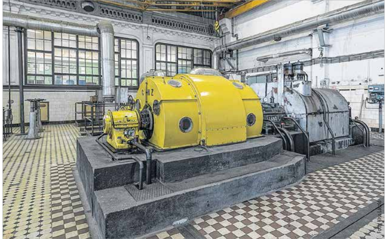
A turbina 1960-ban került a helyére. A mögötte található villamosvezérlő 1926-ban nyerte el jelenlegi formáját. Lapunk fotósa, Kiss László körpanorámás képet is készített a turbinát befogadó csarnokról, ami a http://360szekesfehervar.hu/pano/futoeromu/turbina.html címen látható.
