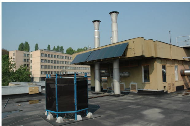
1. ábra: Napelemek a Bécsi úti épületen
