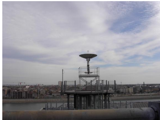
Műholdvevő-állomás a lágymányosi épület tetején.
