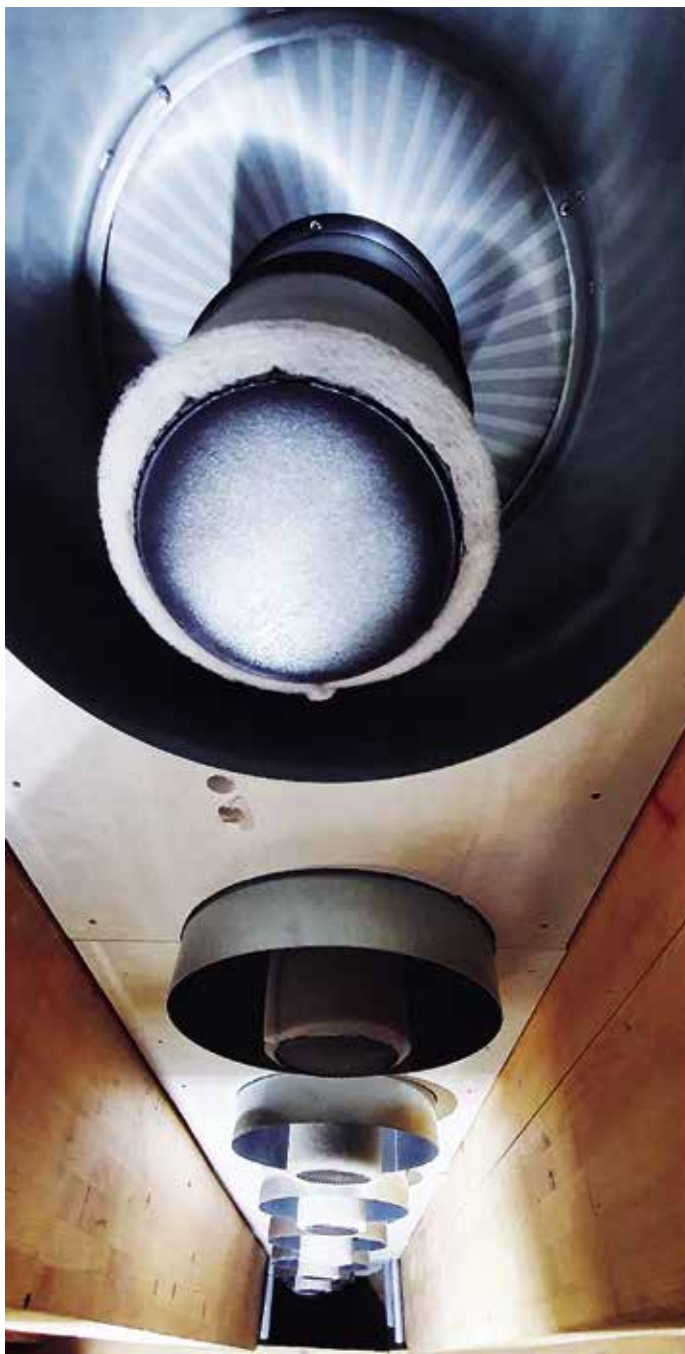
A nyomótér és a zsöllyepadló közötti szellőzőrács alulnézetből. A középső rész a szellőzésért felelős, a külső gyűrű az akusztikai csatolást segíti
