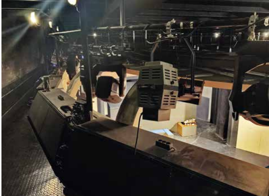
Kényelmesen járható nézőtéri világítási híd a Thália Színházban
