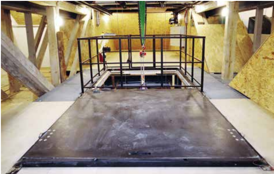
A csillár feletti leeresztő szerkezet nyílását lezáró lap
