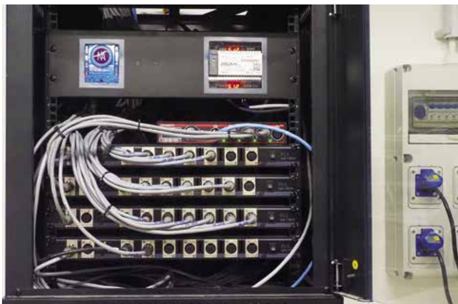
Gyengeáramú vezérlő rack
