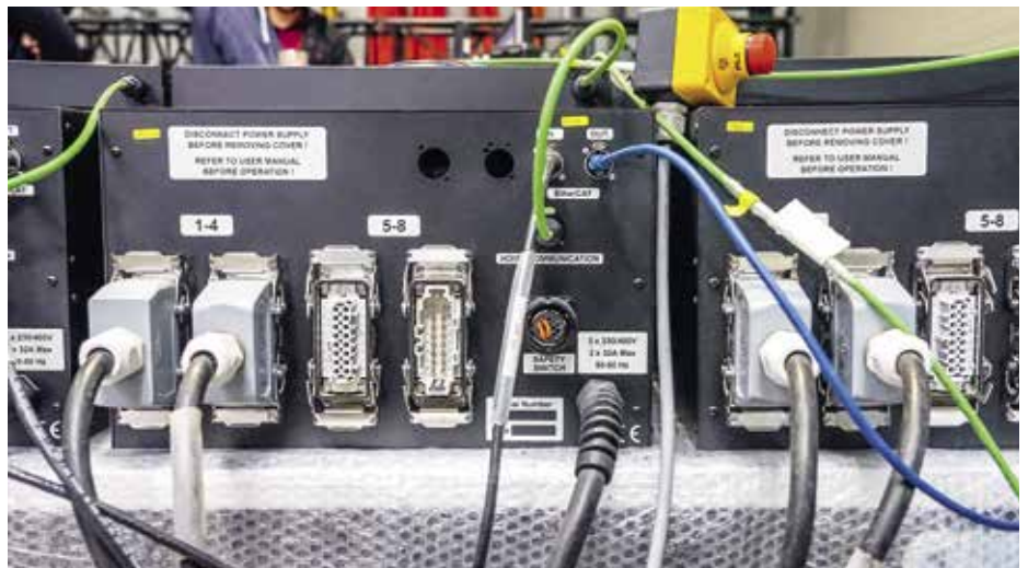
A vezérlődobozok hátoldala a csatlakozókkal
