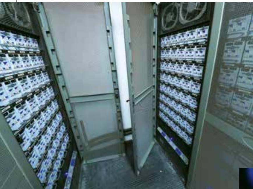
Teljesítményszabályozók a Strand Lighting EC21 szekrényekben
