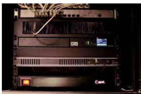
► Rack a vezérlőelemekkel
