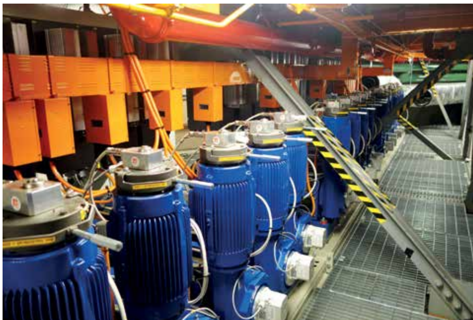
► Az új zsinórpadlás: a felségépezet korszerű gépegységei telepítését a meglévő tetőszerkezethez igazították
