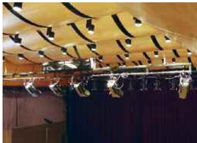
Hangvető mennyezet a világítási tartókkal
