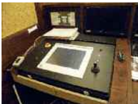
Ügyelőpultba épített kezelőpanel
