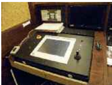
Ügyelőpultba épített kezelőpanel
