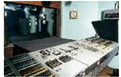
11. ábra. FV 120/A áramkörös két előbeállító, elektronikus vezérlőasztal (Madách Színház, 1977)
