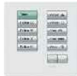
A Színházterem technikai helyiségében található nyomógombos kezelőpanel
