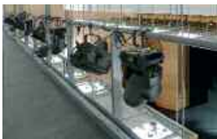
Világítási híd a Színházteremben
