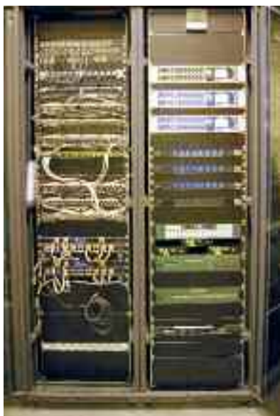
Technikai rack szekrények
