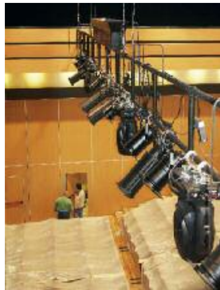
Világítási tartó a hangverseny teremben
