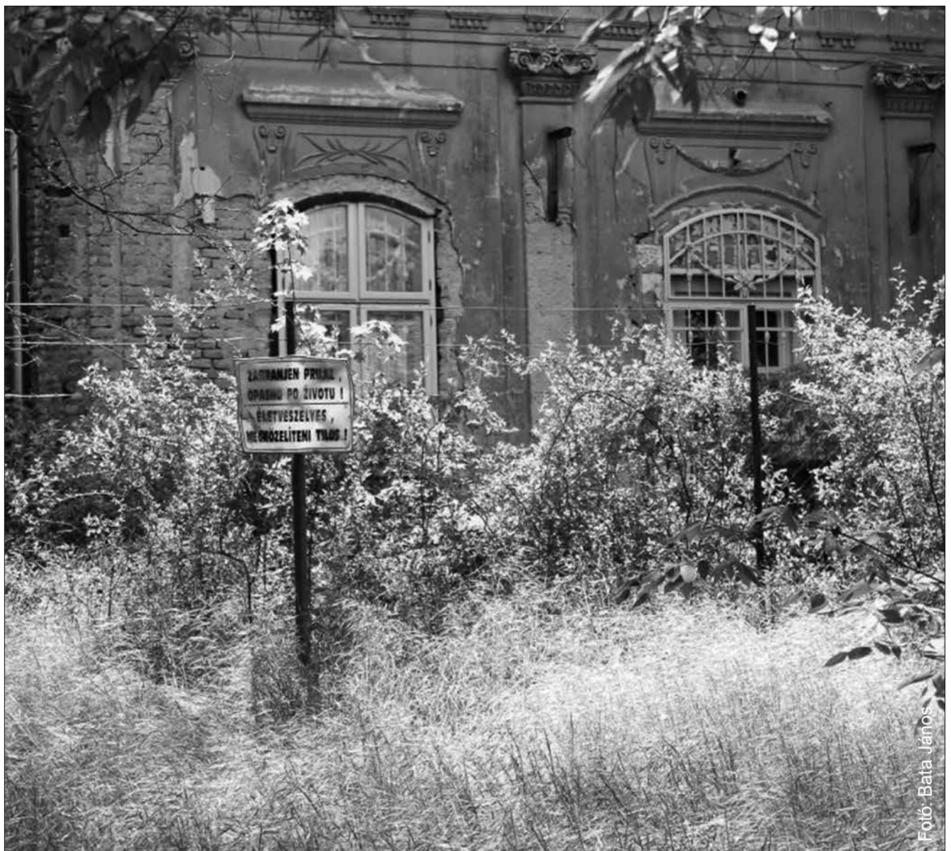
Horgos alapítójának, Kárász Miklósnak a kastélya és környéke a tetőfedés és ablakcserék ellenére 2020 áprilisában ilyen látványt mutat, ami az utókor viszonyulásáról tanúskodik
