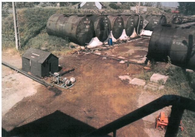
12. ábra. Debreceni repülőtér készenléti üzemanyag-tárolói
