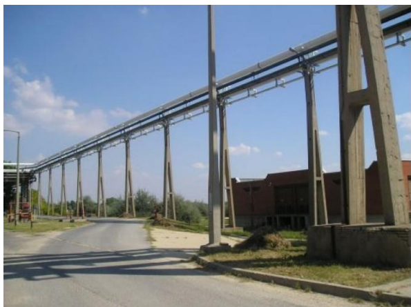
3. ábra Földfeletti többtámaszú csővezeték
