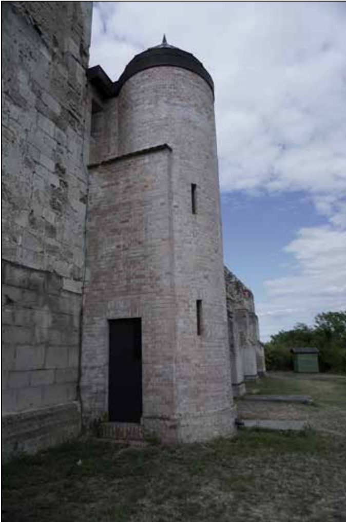
■ 6. kép: A déli lépcsőtorny © MEZŐS Tamás ■ Photo 6. The southern stair tower © Tamás MEZŐS
