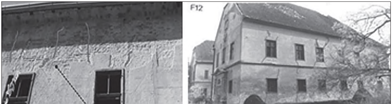
■ Photo 2. Vertical cracking in-plane failure mechanism observed at masonry buildings in the epicentre, Banat area ■ Foto 2. Mecanism de degradare cu fisuri verticale în plan, observat la clădiri din zidărie situate în epicentru, zona Banat
