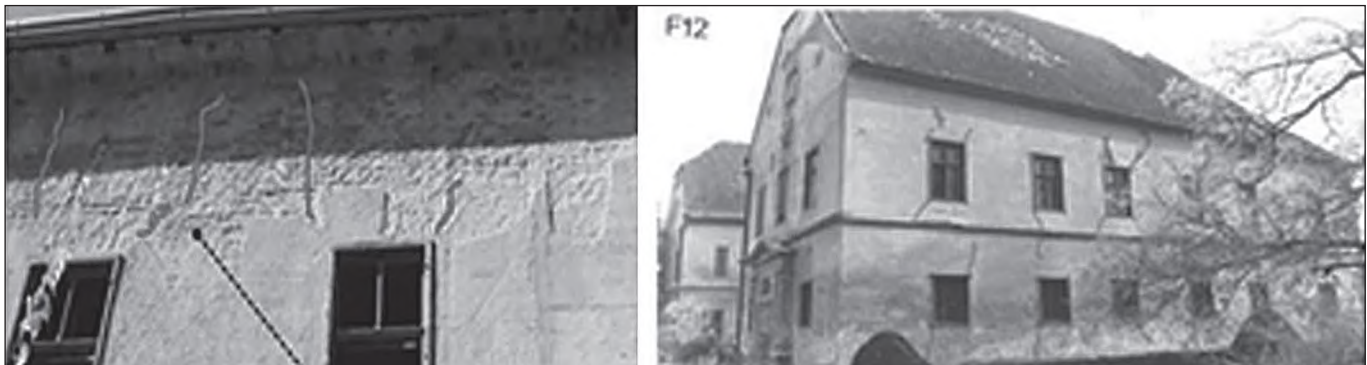
■ Photo 2. Vertical cracking in-plane failure mechanism observed at masonry buildings in the epicentre, Banat area ■ Foto 2. Mecanism de degradare cu fisuri verticale în plan, observat la clădiri din zidărie situate în epicentru, zona Banat
