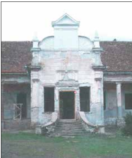
■ Foto 15. Mălâncrav, Conac Apafi, intrare principală înainte de restaurare © MET ■ Photo 15. Mălâncrav, Apafi Manor, main entrance before conservation © MET
