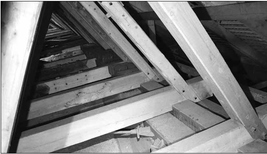
■ 23. kép: Szarufa–kötőgerenda kapcsolatok a szentély feletti tetőszerkezetben a felújítás után, 2016 ■ Photo 23. Common rafter and tie-beam joints in the roof structure above the choir after the renovation, 2016
