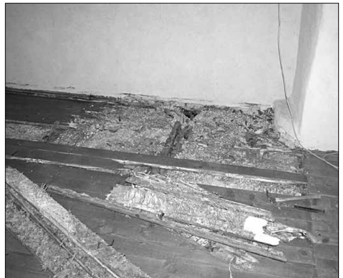
■ 2. kép: A könnyező házigomba kártétele ■ Photo 2. Decay caused by the dry rot fungus
