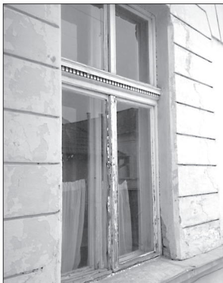
■ Foto 8. Imagine a stării actuale a ferestrelor ■ Photo 8. Image of the current state of the windows
