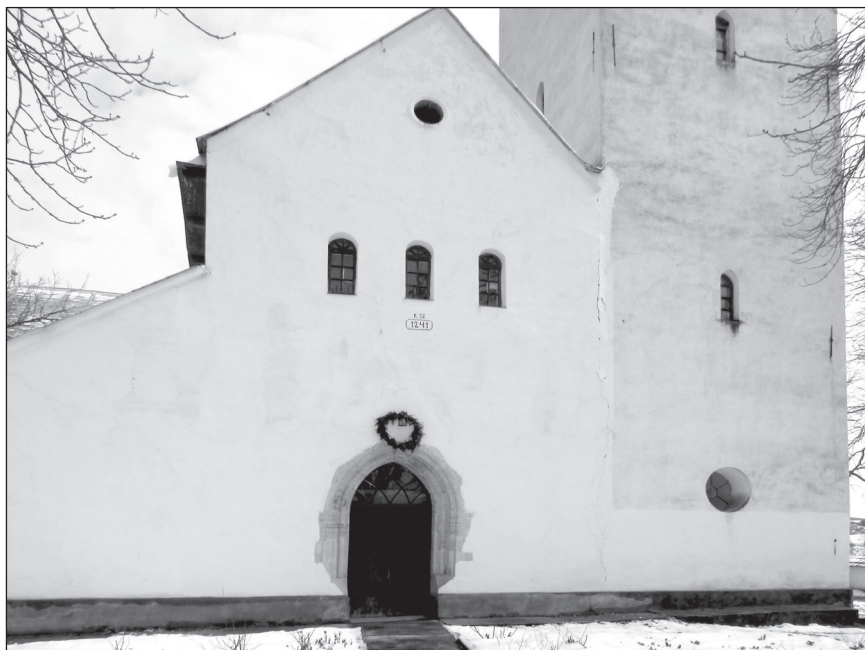
■ Foto 1. Fațada de sud-vest înainte de restaurarea din 2013-2015 © Boróka SÁNDOR ■ Photo 1. The south-western elevation before the conservation of 2013-2015 © Boróka SÁNDOR
