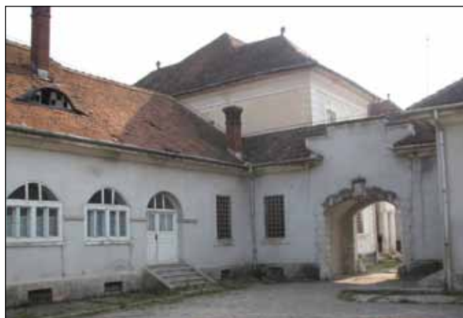
■ Foto 4. Gangul de legătură dintre curtea de acces și peronul prevăzut între fațada sud-vestică a castelului și grădina ornamentală. © Andreea MILEA, 2014
