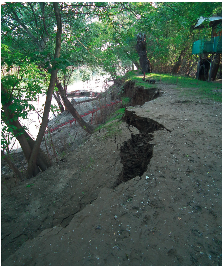
4. kép A partszakasszal párhuzamos, a növények gyökerei mentén előrejelzett repedések (Fotó: KIS MOLNÁR I.) Picture 4 Cracks parallel with the bank performed by tree roots (Photo by KIS MOLNÁR, I.)
