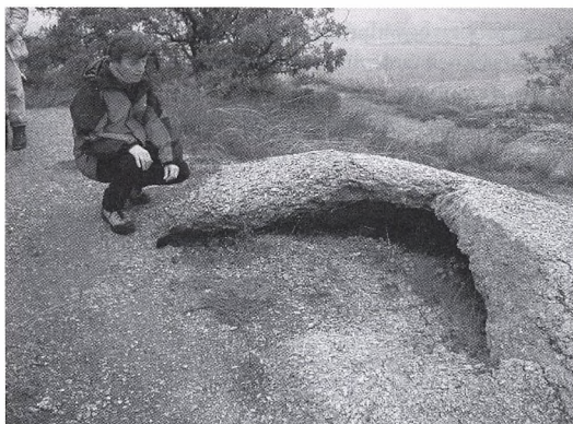
A gipsz térfogatnövekedése következtében kialakult gipszhólyag
