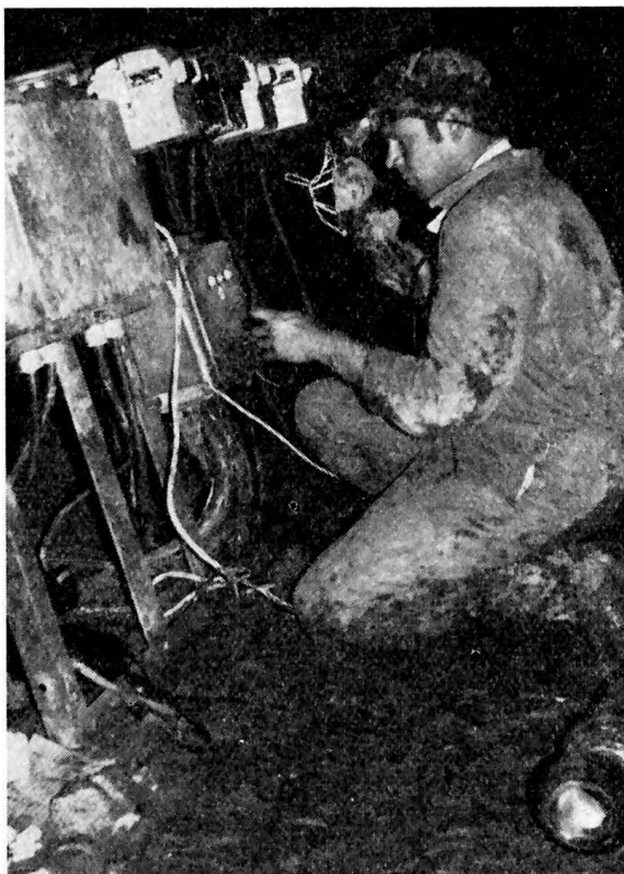
1. kép. A szivattyúcsoport biztosíték- és kapcsolószekrénye
