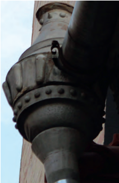
2. ábra. Vízgyűjtő üst földszintes épületen
