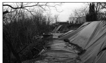
6. kép. Ivó utcával párhuzamos szakadás 1/3 (2011-01-21) (Forrás: Sycons Kft.)
