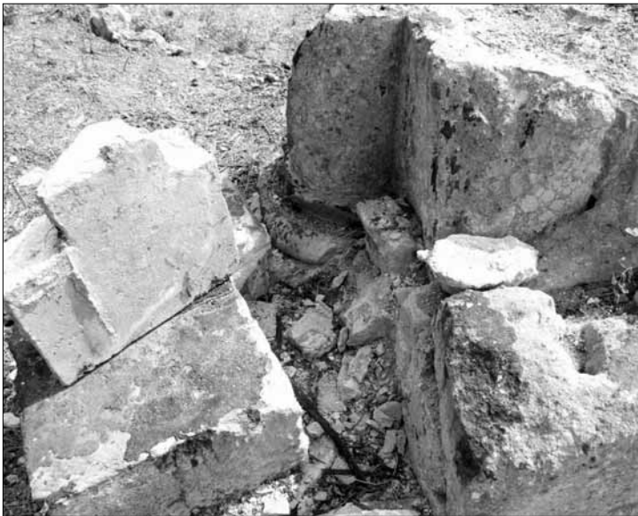
Pilis, az apátsági templom hosszútárájának szétrombolt pillérmaradványa (a szerző fotója, 2007)
