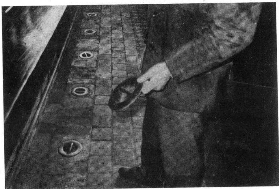
6. kép. Padlófűtés a városháza tanácstermében, baloldalt a tanácstagok padja. Az ülő tanácstag talpa a padlónyláson, amelyen meleg levegő áramlik. A nyílást a jobboldalt látható férfi kezében tartott rézkoronggal fedik be. Lüneburg, Németország. – A szerző felvétele
