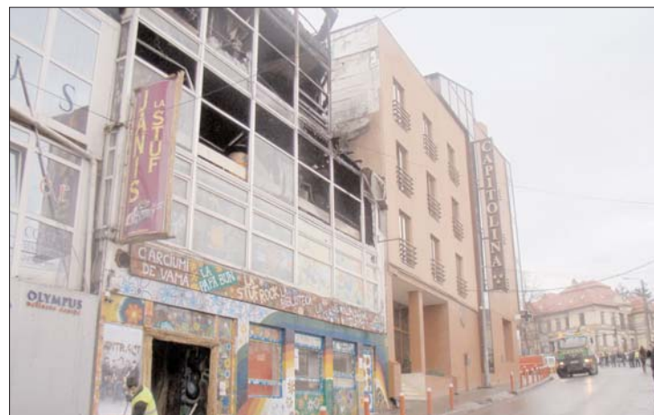
A épület elemesztő tűz tetemes anyagi károkat okozott Fotó: Sipos M. Zoltán
