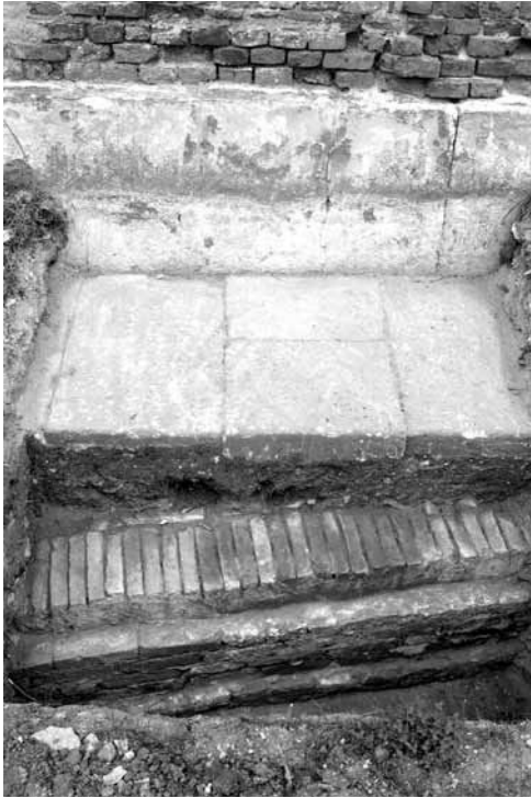
27. kép. Az 1850-es évekből származó csatornarendszer a vele együtt készült lábazati mészkő lapokkal és a főépületet körülvevő kőjárdával. Fotó: Mentényi Klára, 1997
