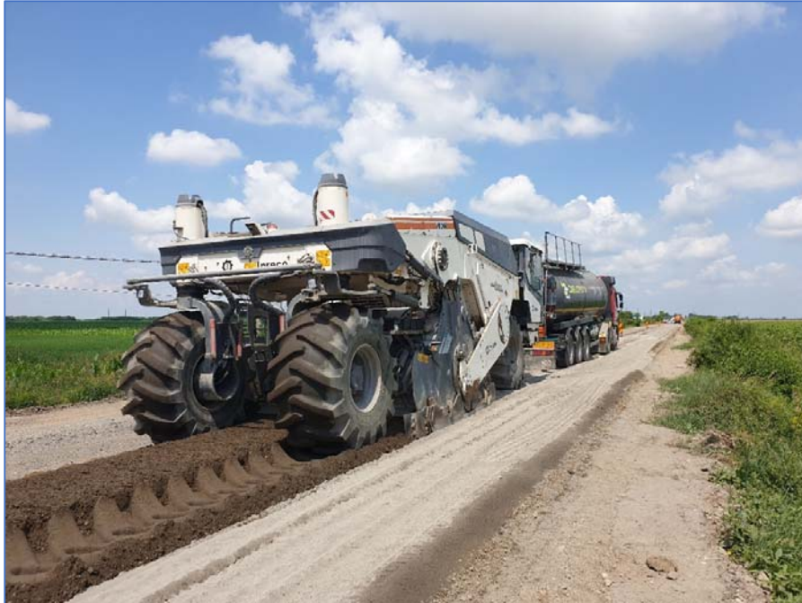
6. ábra Bitumenemulziós hidegremixhez használt géplánc
